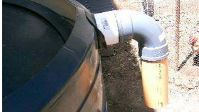
Photo 30. Orifice de sortie de la matière digérée
